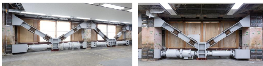
浜松町ビルディング改修時における制振ダンパー設置状況
